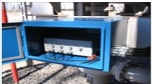
传感器连接于变压器高压套管末屏接地线
